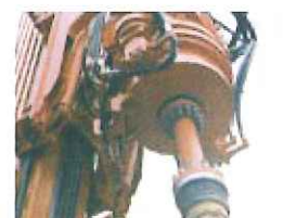
パイプヘッド(オシレーター)
